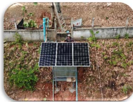
แผงโซลาร์เซลล์ ขนาด 350 วัตต์ 3 แผงและ ปั๊มน้ำท่อ 2 นิ้ว มอเตอร์ดีซี 650 วัตต์
